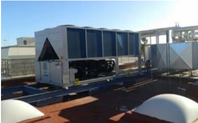
Imagen 10. Nueva enfriadora del módulo A de embarque en Palma de Mallorca
